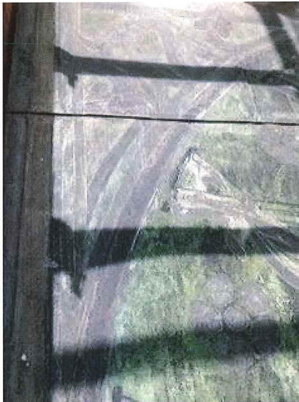
Fot.3 Lewy bok zegara, widoczne przemalowania
